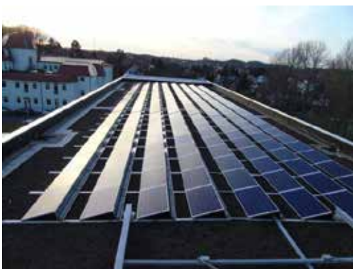
Abbildung 3: PV-Anlage auf Technikum II
